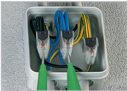
Измерение напряжения через отдельные тестовые гнезда.
